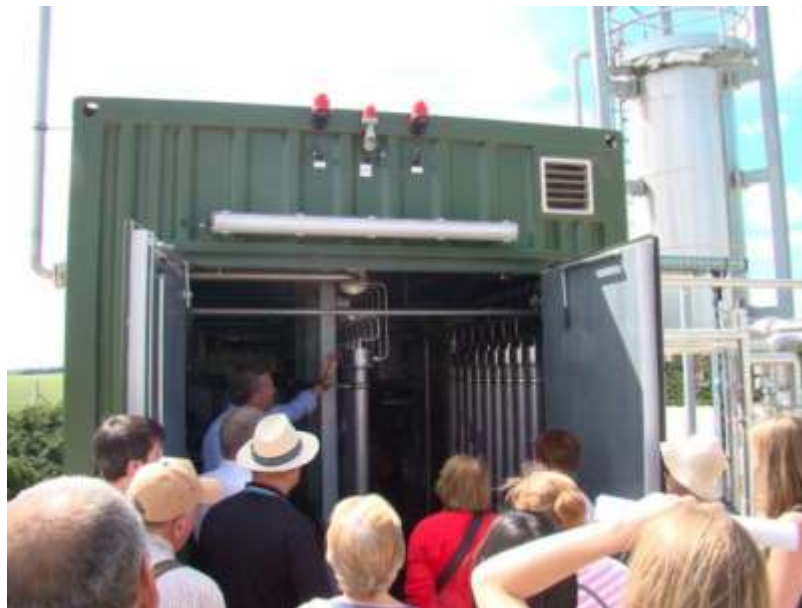
Conteneur de purification du biogaz
